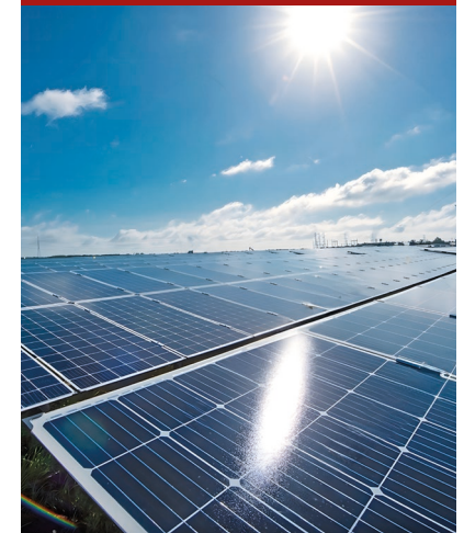
Die Pflege und Reinigung von Solarparks ist ebenfalls Teil unseres Leistungsspektrums.
