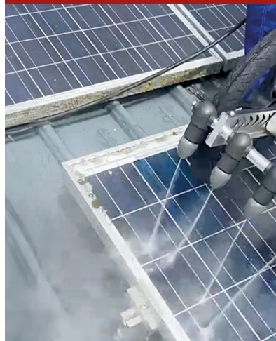
Unsere Spezialgeräte entfernen mit Hochdruck zuverlässig Flechten und Moose.
